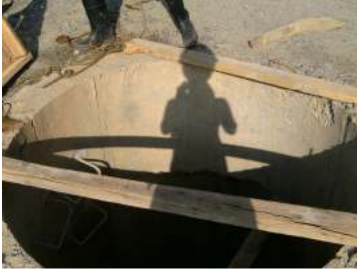
Entrada a un "Box colver" o caja de aguas residuales, un tipo de E.C en el campo de la construcción
