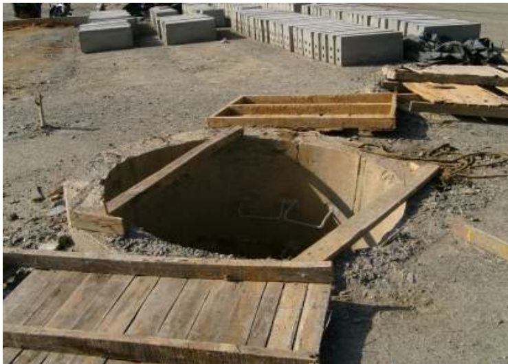
Carencia de seguridad y señalización insuficientes e inadecuadas
